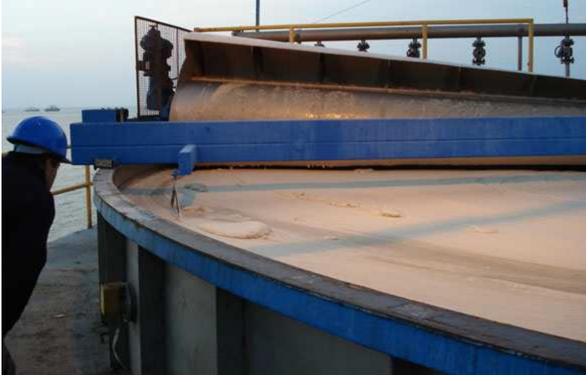
Tanque de flotación química
