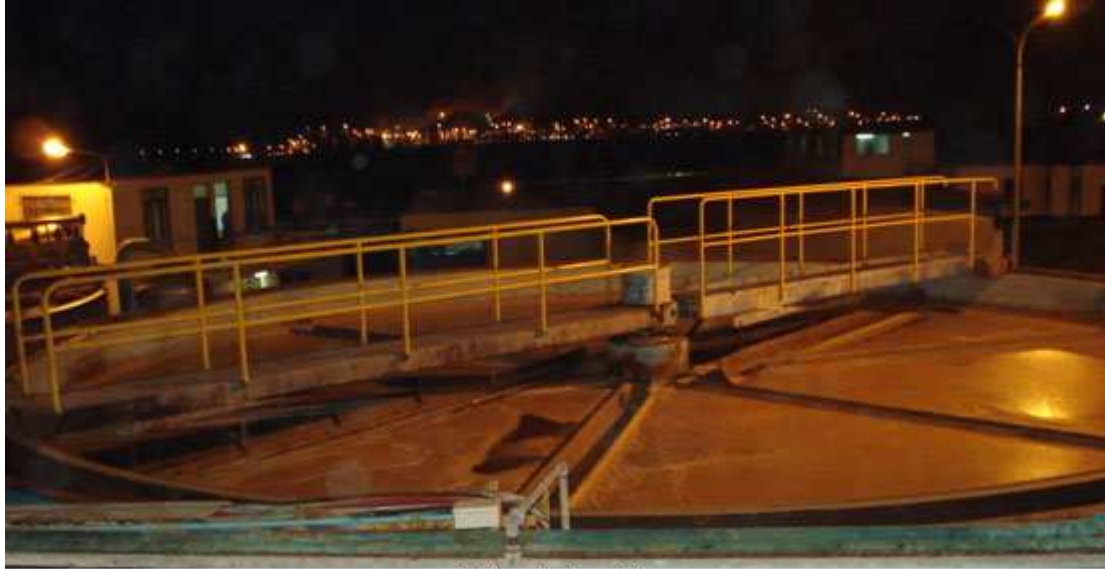
Celda de flotación
